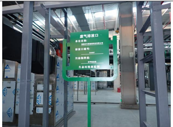
涂布烘干废气处理设施
