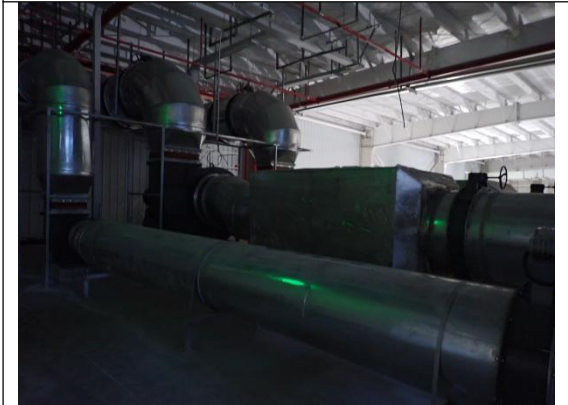
一次注液废气处理设施
