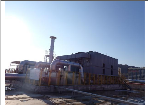
抽真空废气处理设施
