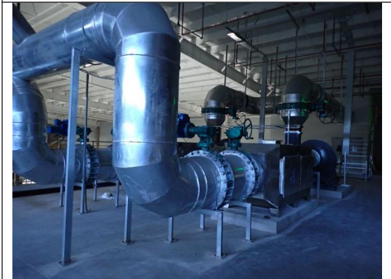
注液前烘干废气处理设施
