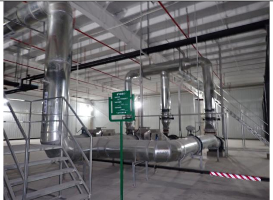
二次注液废气处理设施
