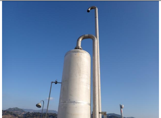
NMP 精馏设施
